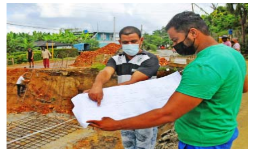
El Intendente de Vialidad en Baracoa (izquierda) y el especialista en obras de ingeniería intercambian a pie de obra.
