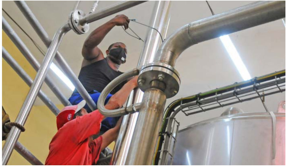
El aislamiento con piezas de aluminio de las tuberías del sistema de agua caliente -por una brigada de Alastor- es una de las pocas tareas pendientes en la industria.
