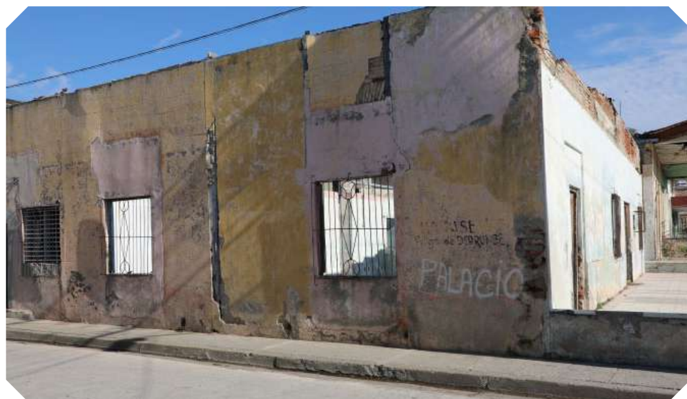
Esta edificación en Máximo Gómez esquina a Emilio Giró amenaza a los transeúntes que pasan sin advertir el ya borroso cartel que anuncia Peligro.
