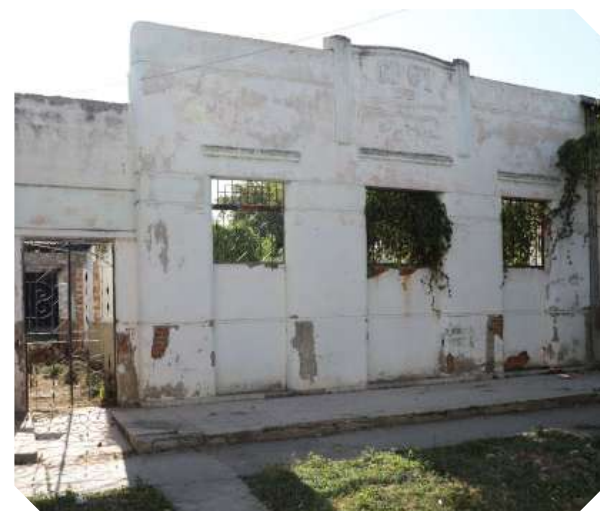
Aunque se ha intentado, por migajas, su recuperación, el deterioro no deja de avanzar en la otrora sede de la compañía Danza Libre, en Máximo Gómez entre Donato Mármol y Bernabé Varona.
