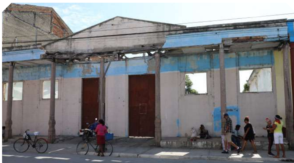
El antiguo almacén de harina, ubicado en Los Maceo entre Flor Crombet y Emilio Giró, representa un riesgo inminente a la vida en una concurrida arteria, donde justo al lado tiene al popular Mercado climatizado Santa Catalina.
