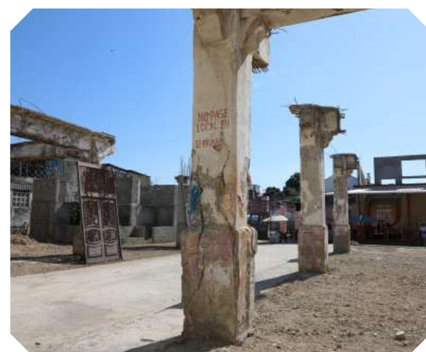
La Plaza del Mercado Centro ya perdió una de sus distintivas cúpulas, y el deterioro no deja de avanzar en las restantes y en la parte aún sin reparar del interior.
