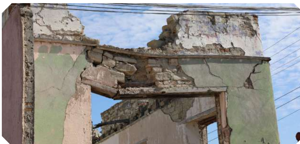
La ruina de lo que antes fue un taller en Los Maceo entre Bartolomé Massó y Donato Mármol, sigue desafiando a la vida. Tiene más potencialidad de ser un parque o plaza, que nuevamente edificio.
