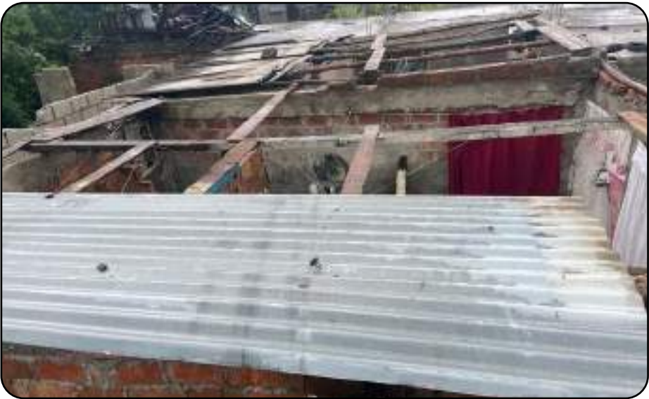
Otros estragos en viviendas.
